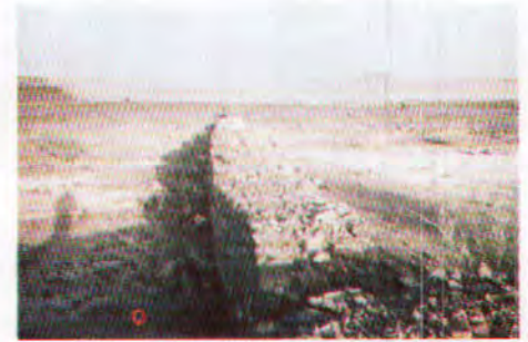
(١٠) (وادي الرانوناء) صورة تمثل الجزء الشرقي من السد حيث حوض السد ومنطقة تجمع مياهه .
