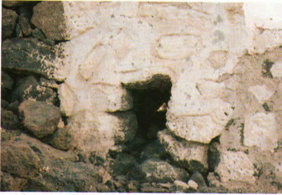
(١٤) (وادي الرانوناء) صورة تمثل بعض الفتحات الأرضية للسد والتي تتسرب منها مياه السد بشكل بطيء لضمان عدم انهياره.
